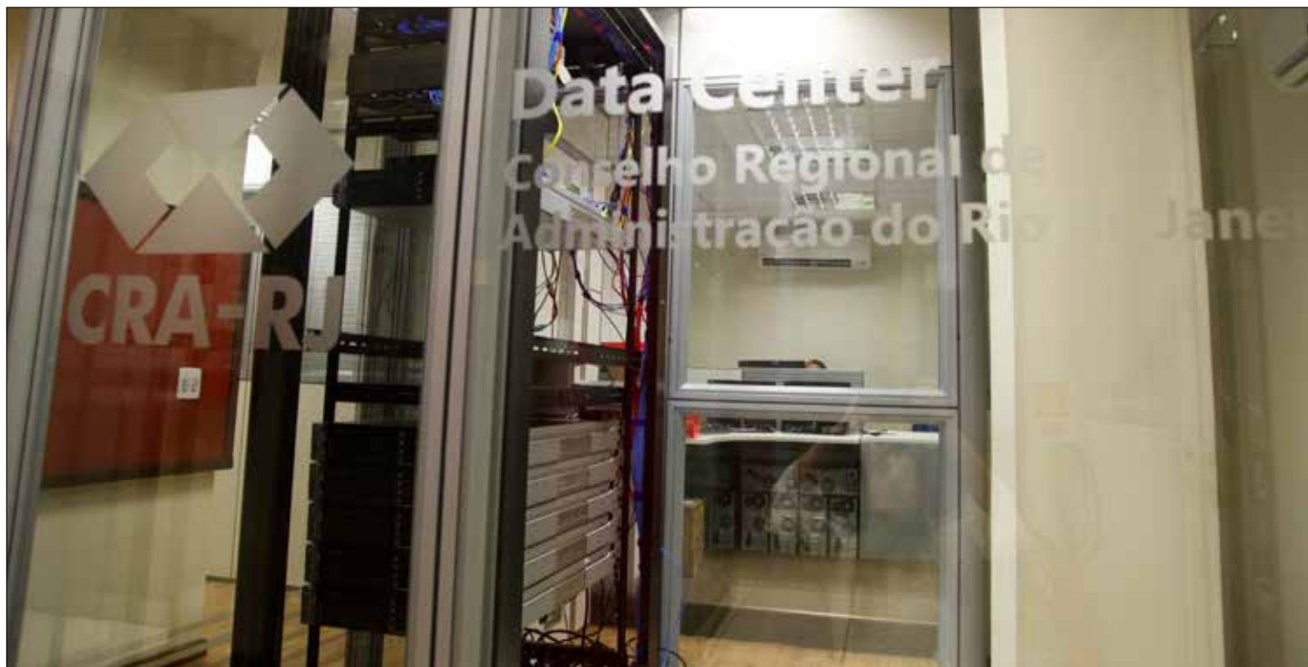
Datacenter instalado no quarto andar do Edifício Adm. Belmiro Siqueira
